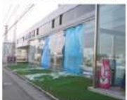
ショールームの壊れたガラス
