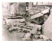
倒れたブロック塀
