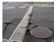
地割れた地面
