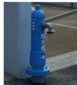
水道局では、災害時に市民の徒歩圏内に給水所を開設できるよう、指定避難所となる小学校などに災害時給水施設の整備を進めている
